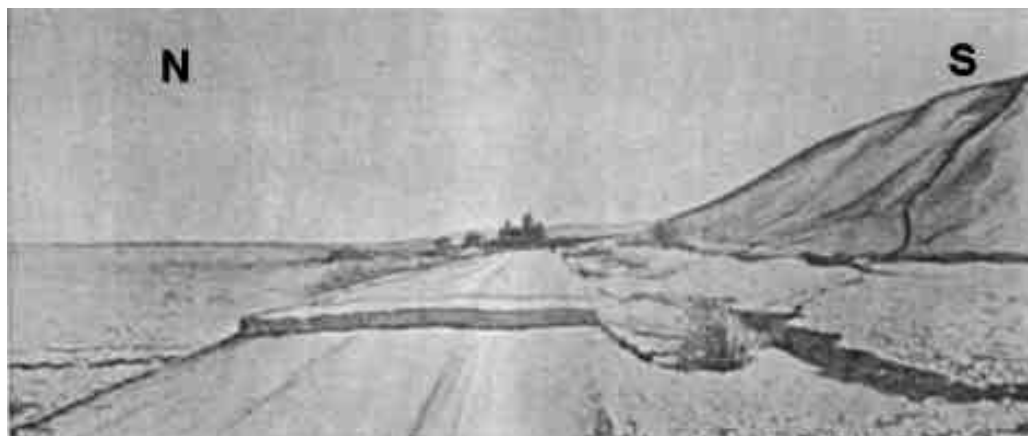
Figura 2. Falla La Laja 1. Ruptura histórica sobre la calle La Laja. (tomado de Castellanos, 1945).
