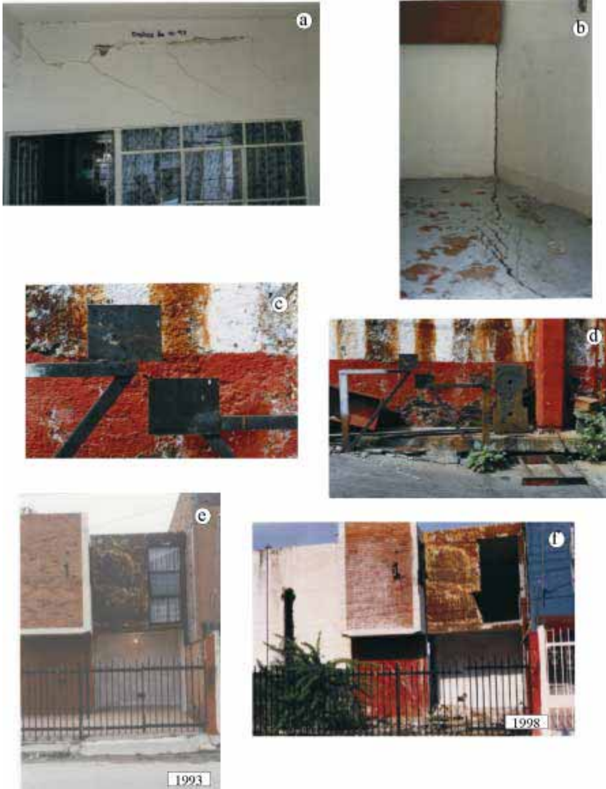
Lámina 1. a y b. Fracturamiento del piso de una casa que muestra la formación de una zona de transferencia donde se genera un pull apart . Este tipo de estructura se está desarrollando en la zona de la central Camionera, donde las zonas de transferencia hacen aumentar la áreas de influencia de las fallas. En b se puede apreciar cómo es más ancha la zona de daños. c y d. Testigo colocado en la falla de la Central Camionera en 1983. En su inicio las dos láminas se colocaron paralelas, ahora se puede constatar un desplazamiento efectivo de más de 30 cm en la obra civil. e y f. Casa dañada de 1983 (e) a 1995 (f) por la falla La Colina. Se puede apreciar cómo la estructura se va hundiendo hacia el lado izquierdo (NW). Estas fotografías hacen ver el grado de hundimiento que han y están sufriendo las viviendas a lo largo de estas estructuras. Servirá para estimar si es oportuno reconstruir una nueva vivienda o dar otro uso al terreno.
